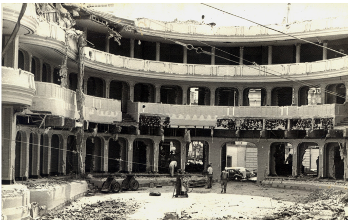
Fig. 17. Demolição do Teatro Municipal Carlos Gomes. Campinas, SP. 17 de novembro de 1965 Fonte: Conjunto Aristides Pedro da Silva. Centro de Memória- -Unicamp. APS 420-71
