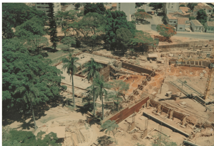
Fig. 24. Centro de Convivência Cultural de Campinas: fotografia de obra, 1968 Fonte: Casa da Arquitectura. Coleção fotográfica do Centro de Convivência Cultural, em Campinas (fotografia n.º 8, PT_CA_ABR_1_A28-02-0008)
