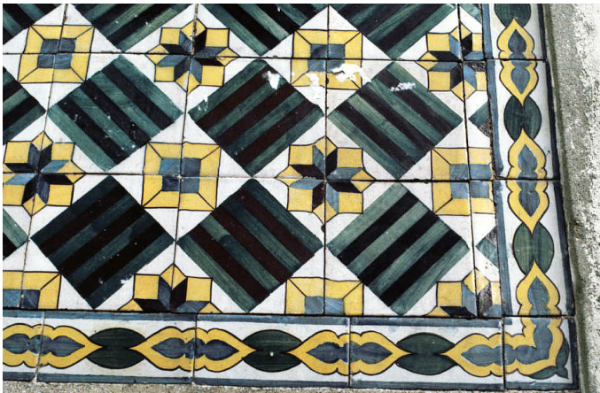
Fig. 63. Padrão de azulejo 2x2 do edifício na Rua do Quelhas, 45/55, conhecido como «travessão» Fonte: Biblioteca de Azulejaria e Cerâmica Portuguesa. Disponível em < https://digitile.gulbenkian.pt/digital/collection/lis/id/2391 >
