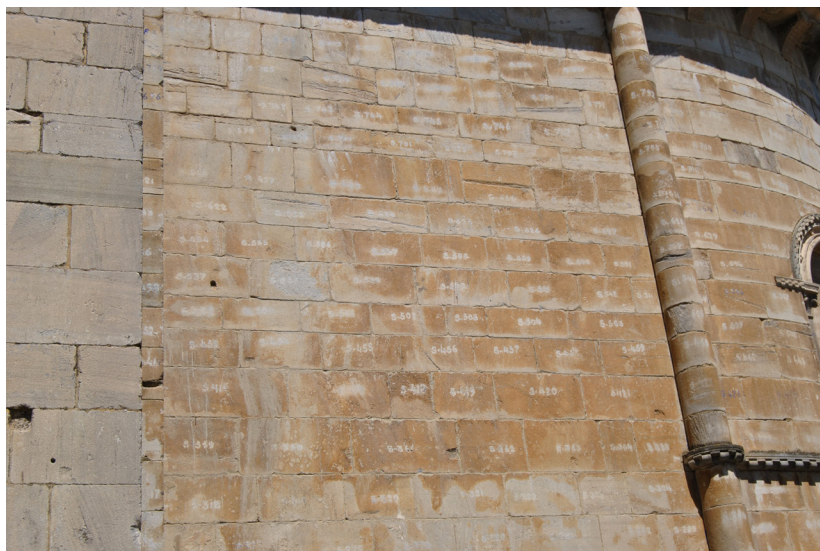
Fig. 4. Detalle de la numeración de los sillares. Iglesia de Portomarín. Fotografía de autor
