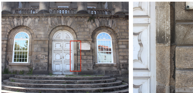
Fig. 2 – Deterioração do granito no torreão Sudeste do Hospital de Santo António, edificado durante o último quartel do século XVIII 16 . Pormenor de uma das ombreiras da porta.
