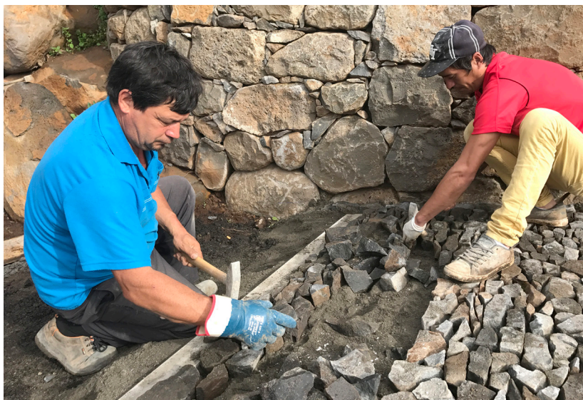
Figura 4 – Aplicação de pedra navalheira sobre uma mistura de areia e cimento. © João Baptista, 2022
