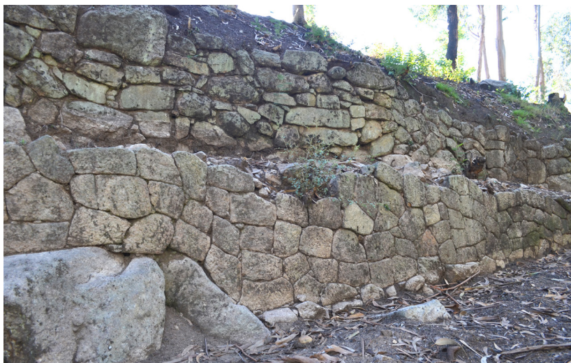
Figura 5— Muralha do recinto superior do castro de Sabroso. A face da muralha apresenta um aparelho comparativamente pouco coeso, com encaixe débil e mau travamento entre as pedras. Foi erigido um murete de reforço no exterior, com inclinação para escoramento, e ainda que o travamento deste se mantenha deficiente, é notável a qualidade do seu aparelho, assente a seco.
