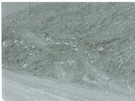
Foto n.º 1 | Estrada Municipal (Murça-Sobreira) após deslizamento de terras.
