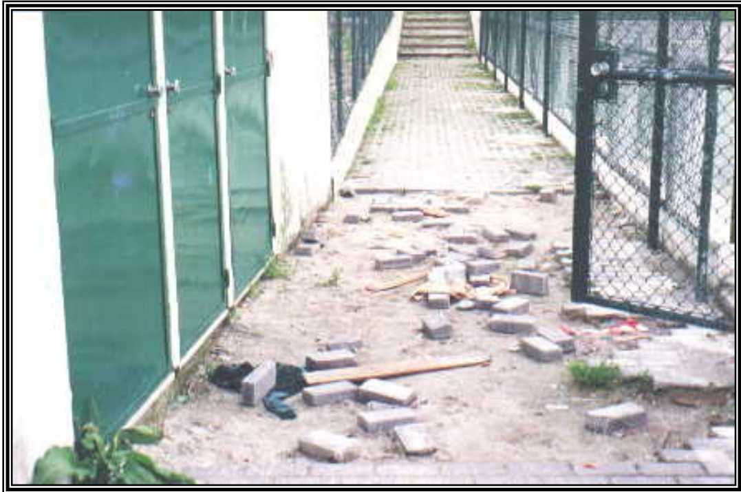
Fotografia 64 – Marcas de vandalismo no campo de jogos, no Bairro de S. Gens
