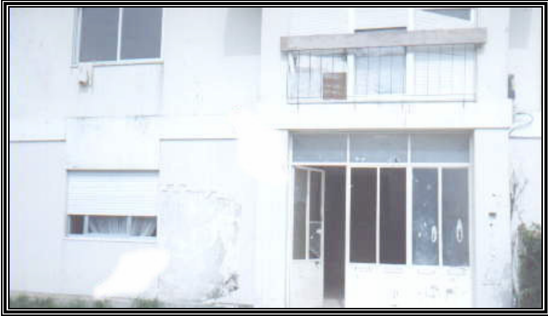
Fotografia 44 – Marcas de degradação no Bairro do Balteiro
