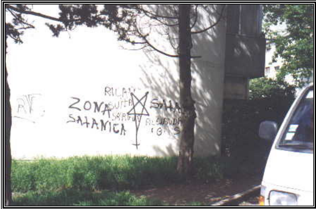
Fotografia 60 – Marcas de vandalismo nos edifícios, no Bairro do Carvalhido
