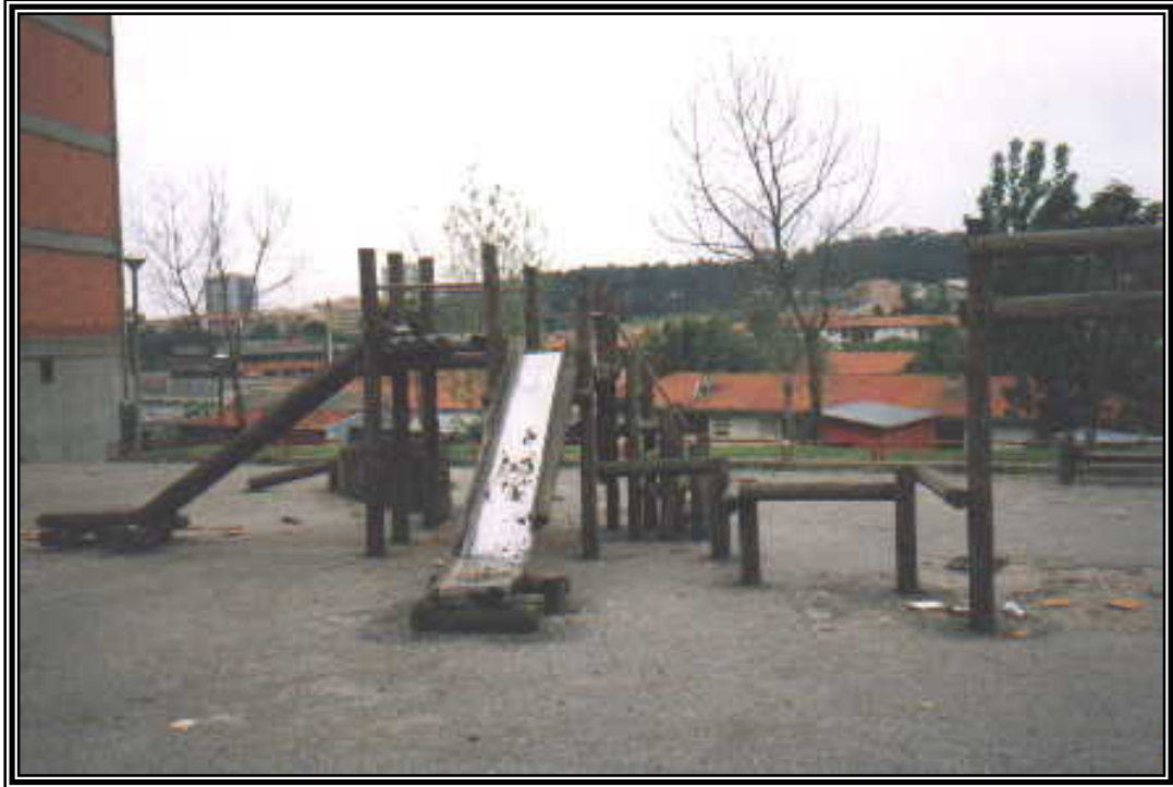
Fotografia 66 – Marcas de degradação no parque infantil, no Bairro de Lordelo do Ouro
