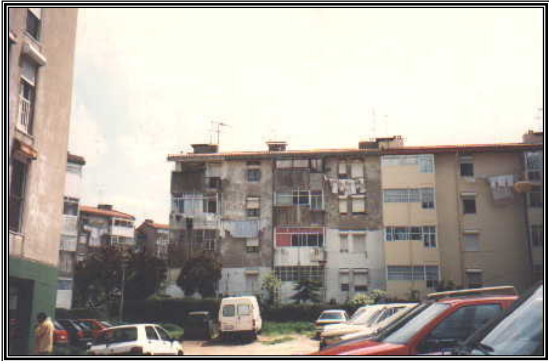
Fotografia 52 – Marcas de humidade nos edifícios e estacionamento “selvagem”, no Bairro da Biquinha
