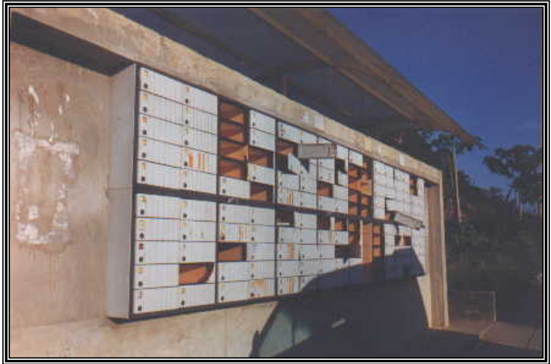
Fotografia 58 – Marcas de vandalismo das caixas de correio, no Bairro da Bela Vista
