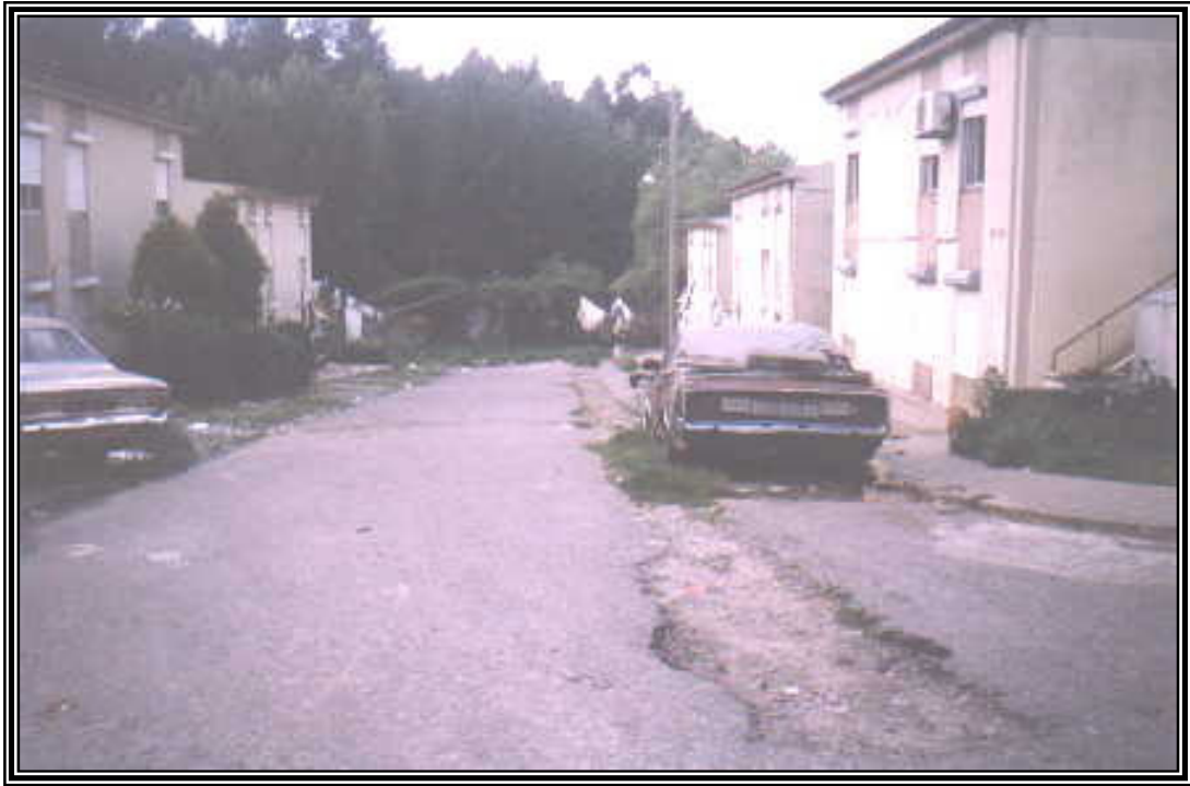
Fotografia 56 – Marcas de degradação nos espaços exteriores (ruas e passeios), no Bairro do Sardão
