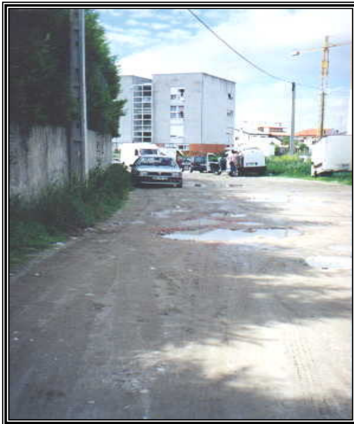
Fotografia 57 – Marcas de degradação nos espaços exteriores (ruas sem pavimentação), no Bairro de S. Gens
