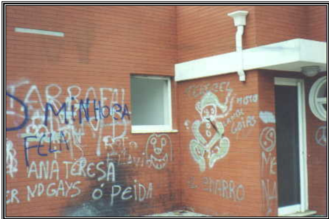
Fotografia 67 – Marcas de vandalismo no balneário do campo de jogos no Bairro da Outrela
