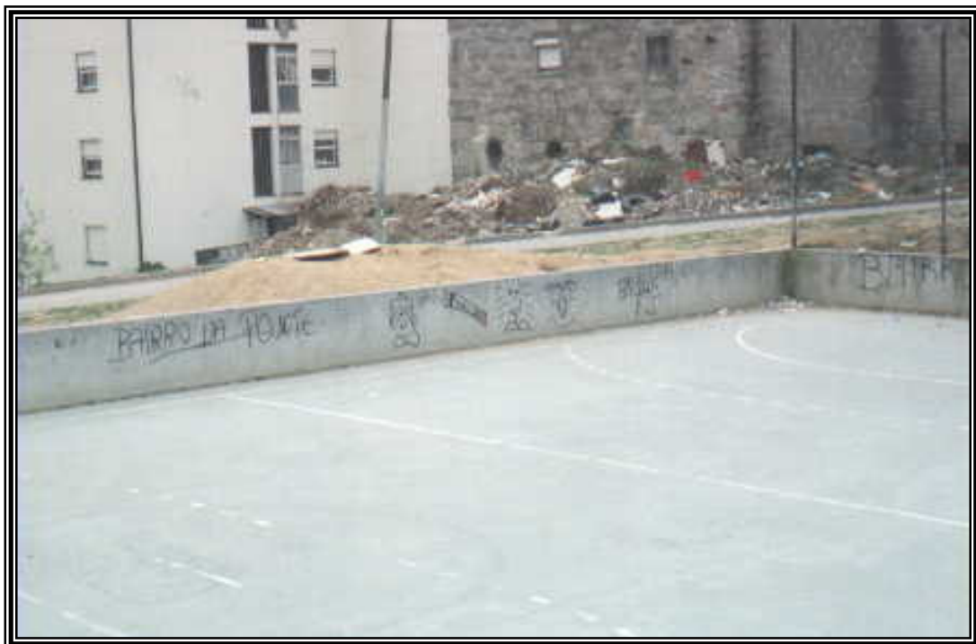
Fotografia 59 – Marcas de degradação e falta de limpeza (lixo acumulado no exterior), no Bairro da Ponte
