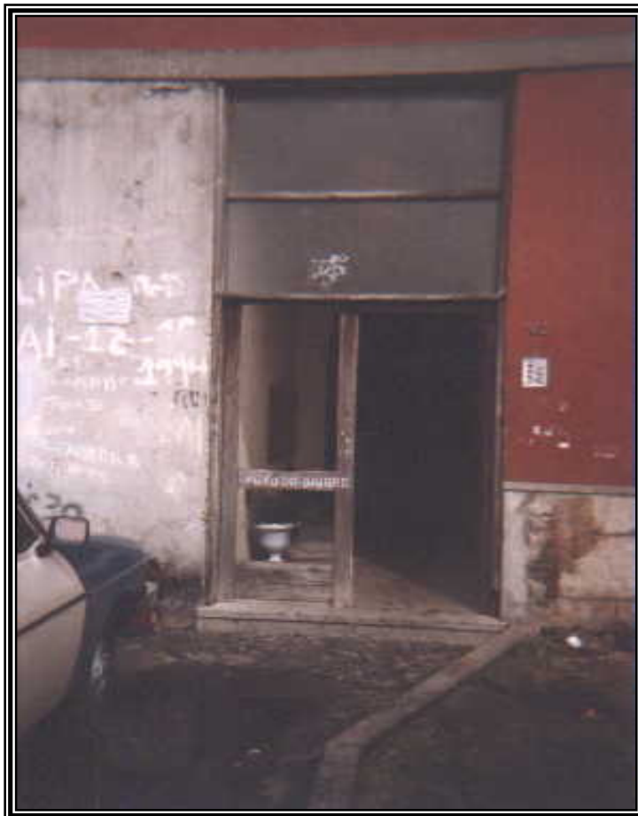
Fotografia 53 – Marcas de degradação na entrada de um edifício, no Bairro de Paranhos
