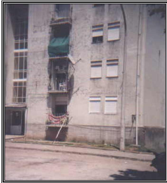
Fotografia 54 – Marcas de degradação e humidade nos edifícios, no Bairro das Pereiras
