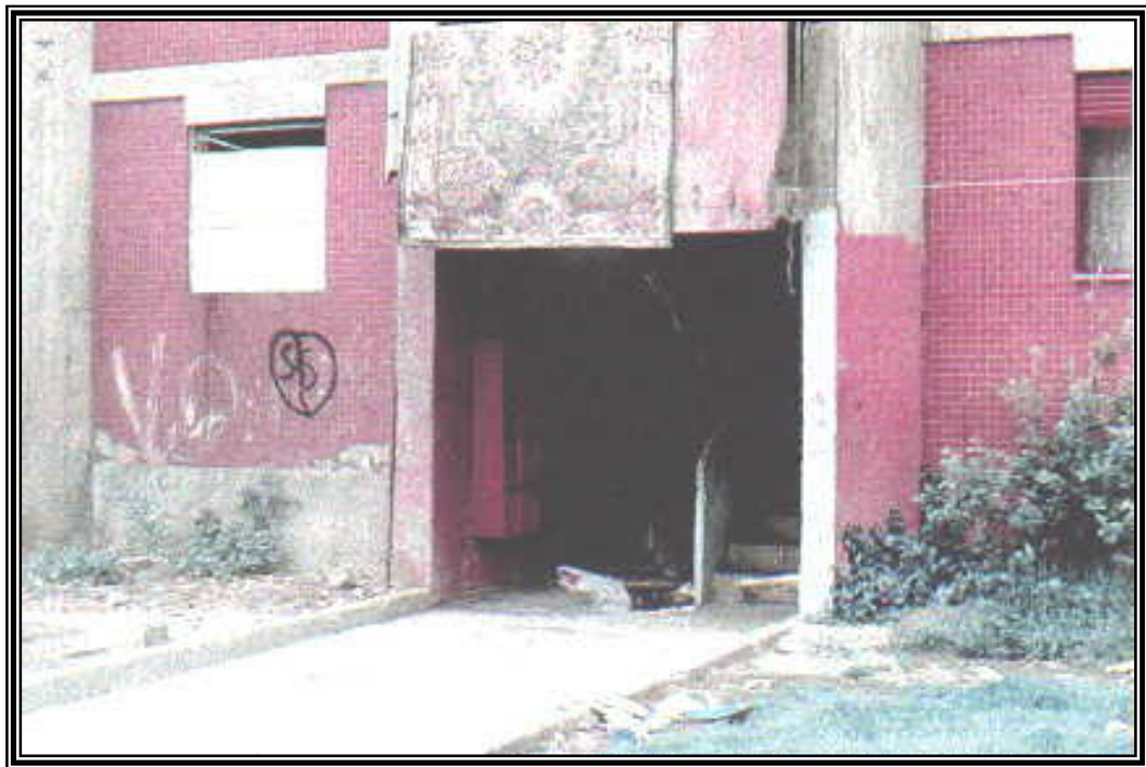
Fotografia 55 – Marcas de degradação e vandalismo de um edifício, no Bairro S. João de Deus
