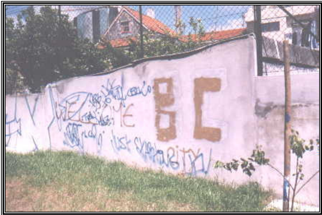
Fotografia 61 – Marcas de vandalismo nos espaços exteriores, no Bairro das Condominhas
